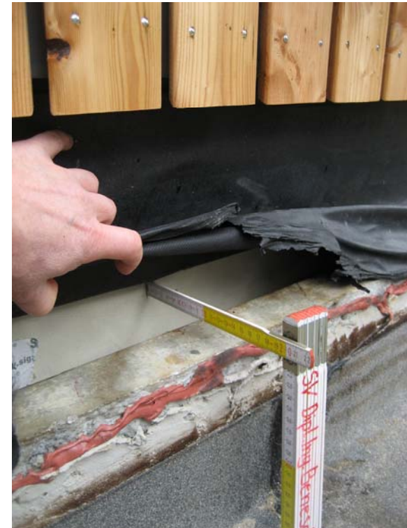
Pflanztrog fehlerhaftes Anschlussdetail
