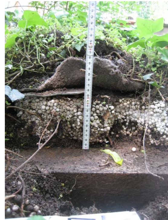
Gründach fehlende Abdichtung
