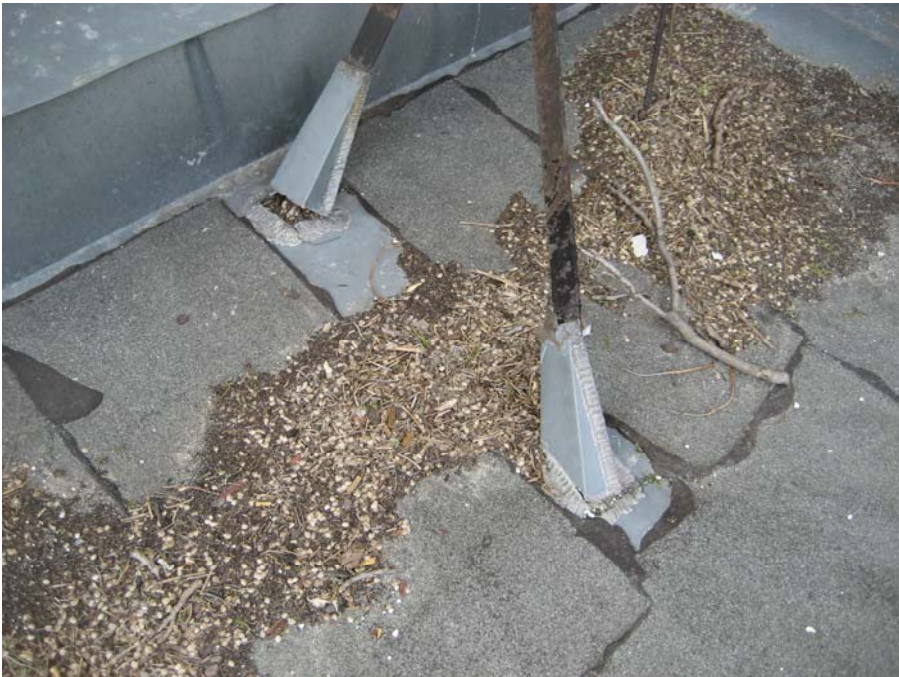
Stehkragen im Bestand defekt
