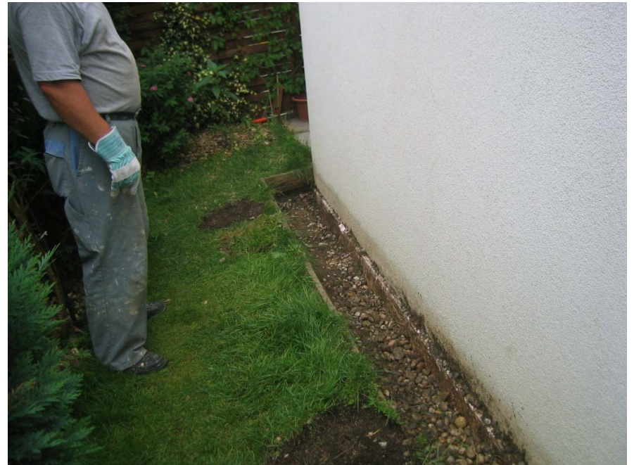
Perimeter fehlende Hochführung
