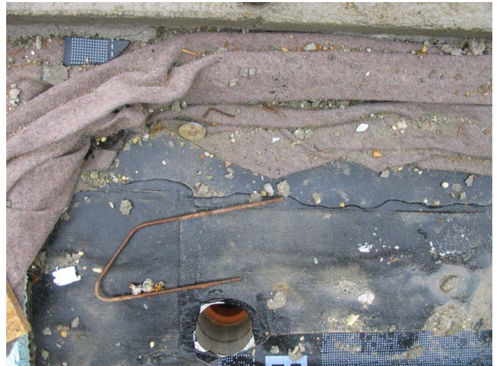
Beschädigungen von Abdichtungen (durch Dritte ?)
