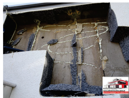
OBERER ABSCHLUSS mangelhaft
