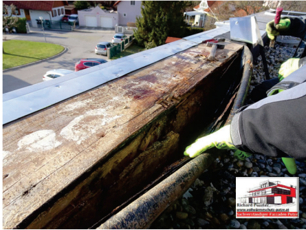
OBERER ABSCHLUSS mangelhaft
