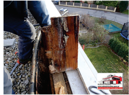
OBERER ABSCHLUSS mangelhaft
