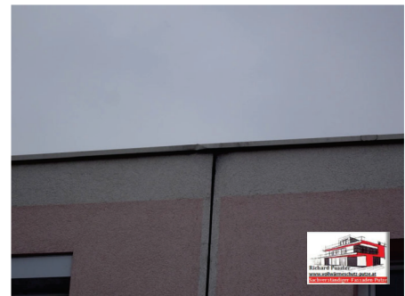
OBERER ABSCHLUSS mangelhaft
