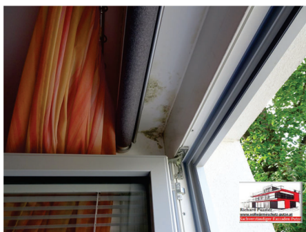
OBERER ABSCHLUSS mangelhaft
