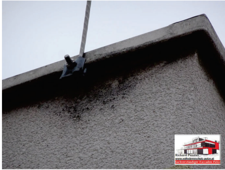
OBERER ABSCHLUSS mangelhaft
