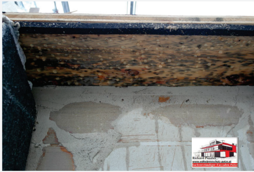
OBERER ABSCHLUSS mangelhaft
