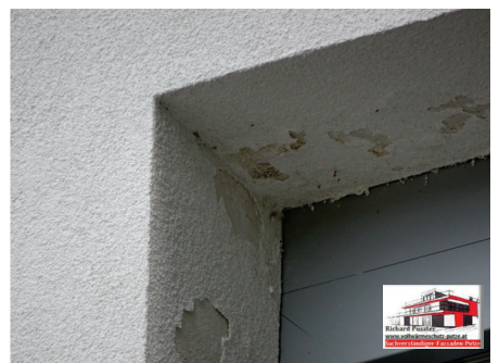
OBERER ABSCHLUSS mangelhaft
