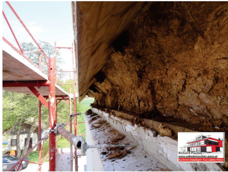
OBERER ABSCHLUSS mangelhaft
