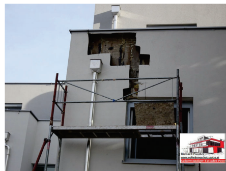
OBERER ABSCHLUSS mangelhaft
