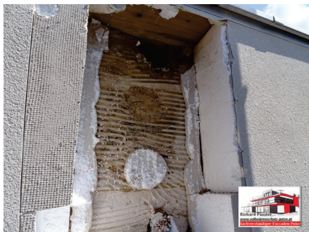
OBERER ABSCHLUSS mangelhaft
