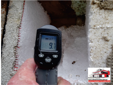
OBERER ABSCHLUSS mangelhaft
