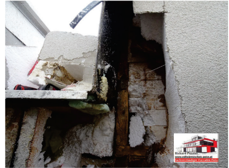
OBERER ABSCHLUSS mangelhaft
