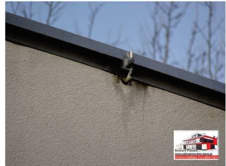
OBERER ABSCHLUSS mangelhaft
