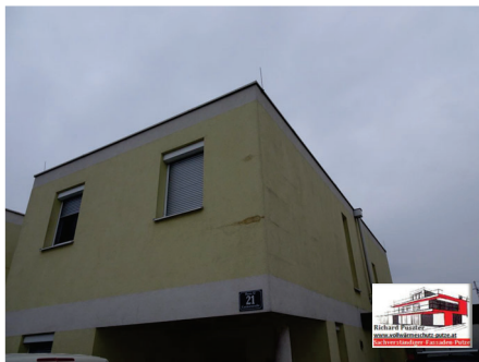
OBERER ABSCHLUSS mangelhaft
