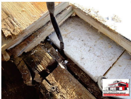
OBERER ABSCHLUSS mangelhaft
