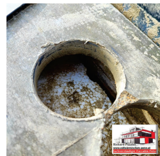
OBERER ABSCHLUSS mangelhaft
