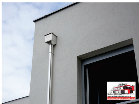
OBERER ABSCHLUSS mangelhaft
