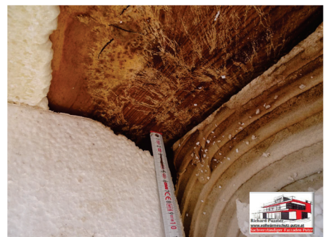
OBERER ABSCHLUSS mangelhaft
