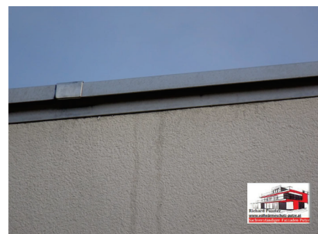
OBERER ABSCHLUSS mangelhaft
