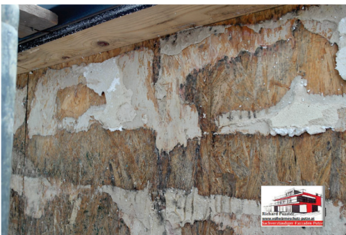
OBERER ABSCHLUSS mangelhaft
