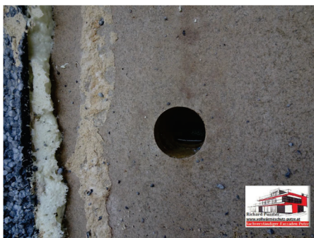
OBERER ABSCHLUSS mangelhaft
