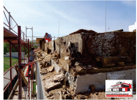
OBERER ABSCHLUSS mangelhaft
