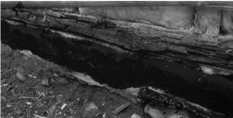
Abbildung 1: geöffneter Sockelbereich mit fäulniszerstörter Holzkonstruktion, welche ca. 10 cm unter dem Außenniveau lag
