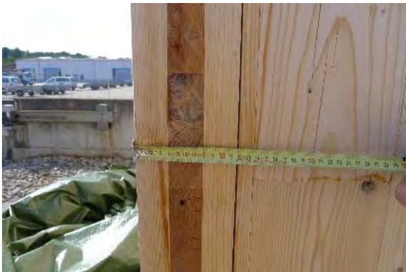
Dicke der Brettsperrholzwände und Decke 12 cm. Die Verbindungsfuge zwischen den Wandelementen wurde mit Dichtstoffen verschlossen.
