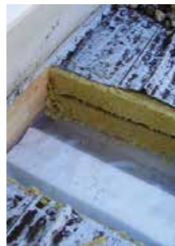
Falsch: Hier wurde die Dampfsperre nicht verklebt, der Randwinkel fehlt.
