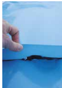
Fehler: offene Verklebung der Dampfsperre oberhalb des Trapezblechs.
