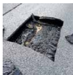
Mehrlagige Abdichtung als Nachteil: Nicht vollflächig miteinander verklebte Bahnen führen hier zu Blasenbildung.
