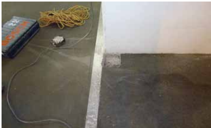
Falsche Ausführung: Unterhalb des Asphalts ist keine Abdichtung vorhanden.
