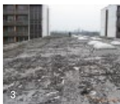
Schäden bei PVC-Dachabdichtungsbahnen.
