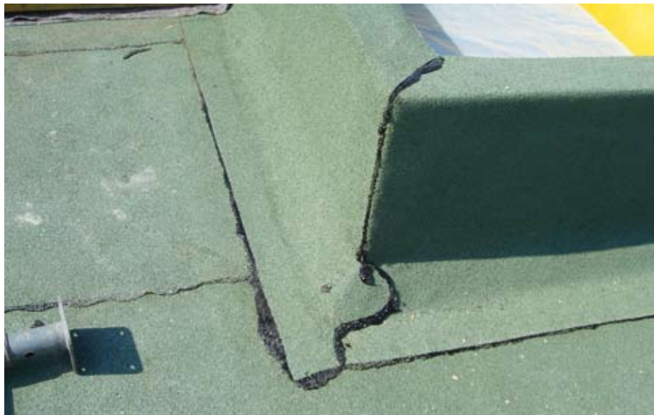
Krankenhaus: Bei der Lichtkuppel muss unter Berücksichtigung der extensiven Dachbegrünung eine Hochzugshöhe von mindestens 15 Zentimetern in Zukunft zur Verfügung stehen.
