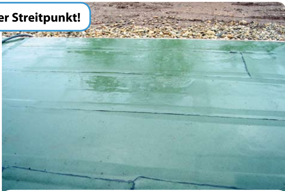
Hier zu sehen ist eine zulässige Pfützenbildung hinter einer Bitumenschweißnaht.
