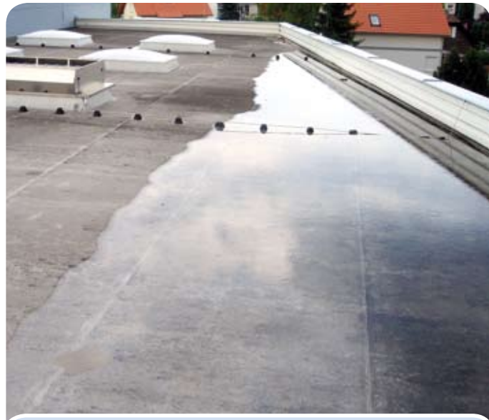
So sollte es nicht aussehen! Ein Wassersee am Dach.
