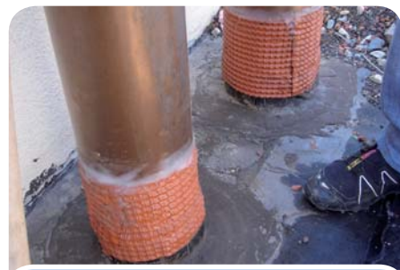
Hier ist eine unkontrollierte Rohrführung zu sehen.
