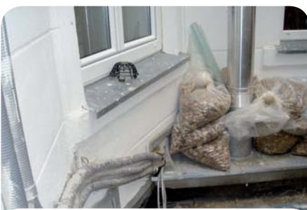
Hier sieht man das falsch verwendete Material bei einer Rohreinbindung.
