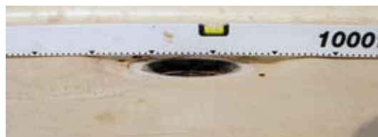
Gully in WD versenkt
