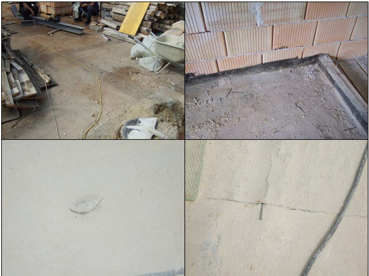
Abb. 9: oben: ungeschützte Bauschutzabdichtungen unten: Schäden an Bauschutzabdichtungen
