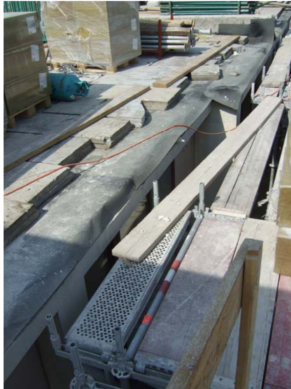
Abb. 6: Ergänzte Bauschutzabdichtung mit Attikabereich, Gefahr der Kondensatbildung im Anschlussbereich Außenwand/Decke in den Wintermonaten
