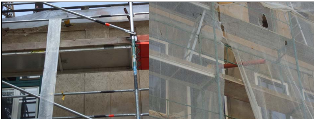
Abb. 11: links: Falleitung nicht ausreichend formstabil rechts: keine Falleitung an die Entwässerung angeschlossen
