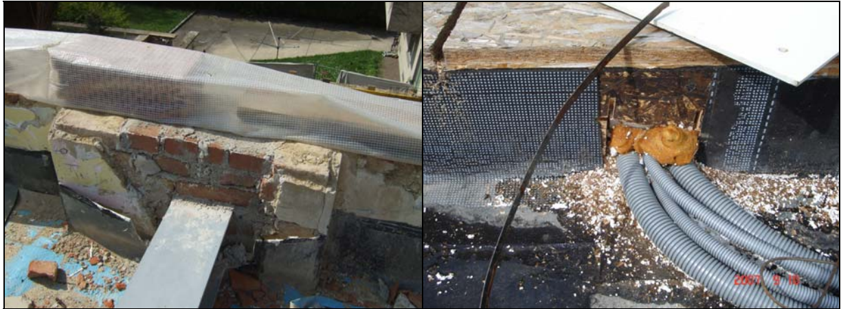
Abb. 10: links: Abdichtungshochzug beschädigt rechts: Abdichtungshochzug nachträglich perforiert
