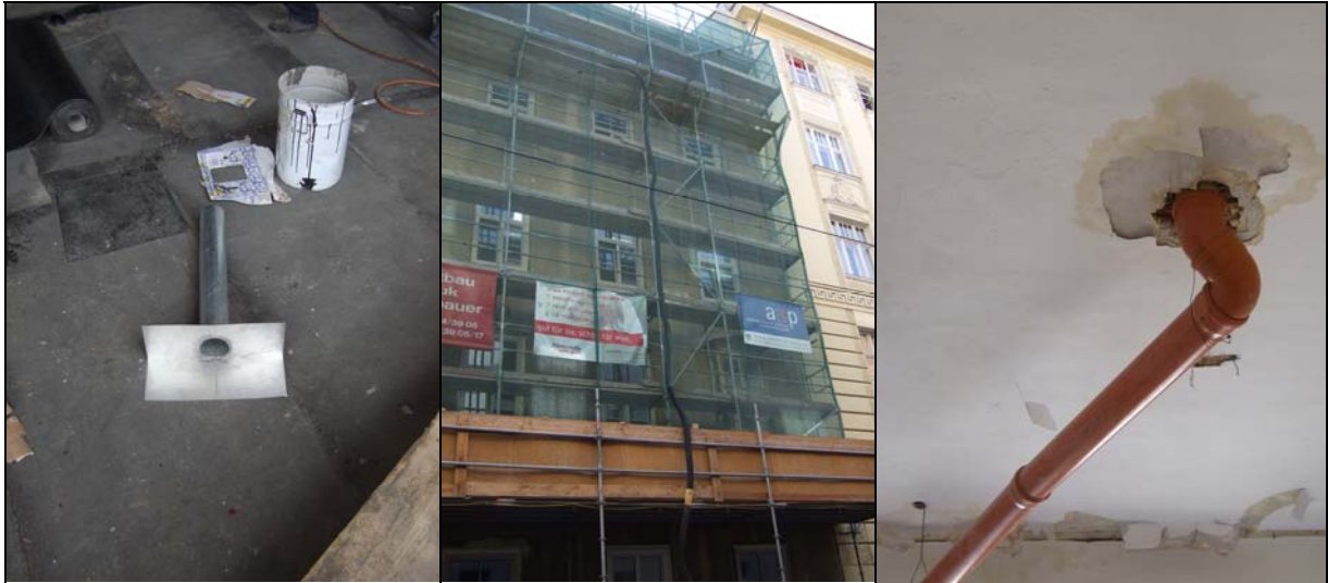
Abb. 2: links: Formteil für Außenentwässerung; Mitte: Ableitung Regenwasser mittels Schläuche rechts: horizontale Verziehung einer provisorischen Entwässerung mittels Rohre
